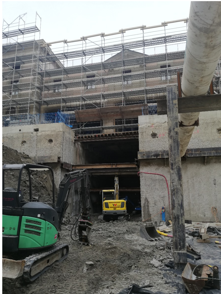
Chantier du nouvel Hôtel des archives. Liaison entre le bâtiment existant et le futur dépôt – terrassement en sous-œuvre décembre 2021
